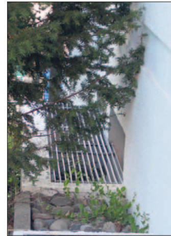
Schwachstelle: der Lichtschacht am Kellerfenster. FOTOS: VA/DPA
